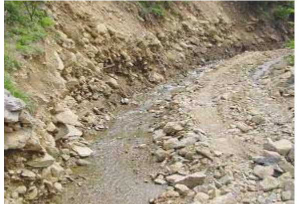
사진1-12 : 광양 옥곡천의 곡류에 따른 공격사면 산록부의 침식 - 하천 곡벽의 침식은 상층부의 붕괴를 유발한다
